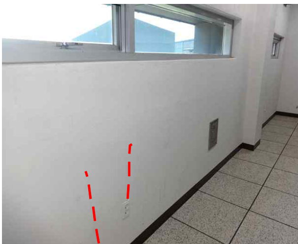
내부 벽체 마감 균열 (CW=0.2mm, L=0.5m, 2EA)
