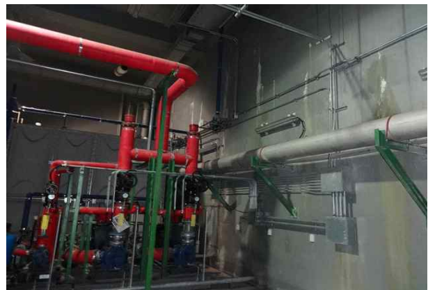
유입펌프장 벽체 백태 (A=10.0m×5.0m)
