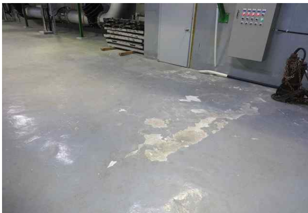
외부 바닥 도장들뜸 (A=5.0m×3.0m)
