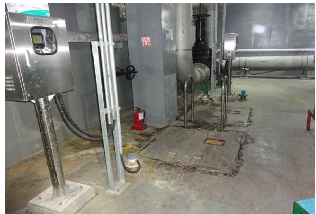
외부 바닥 누수흔적 (A=2.0m×2.0m)
