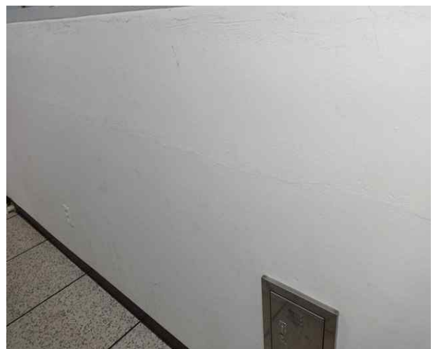
내부 벽체 마감 균열 (CW=0.2mm, L=0.5m, 3EA)
