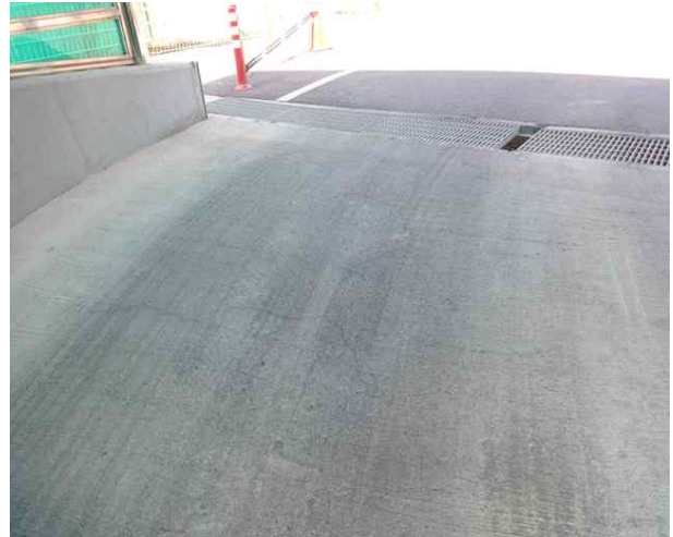
바닥부 망상균열 (A=3.0m×2.0m)
